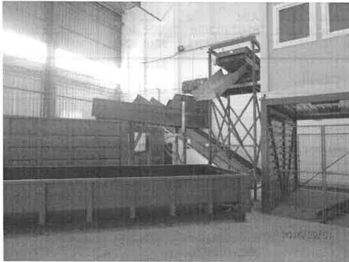
Figura nr. 4-18 Stația de sortare – echipament 4
