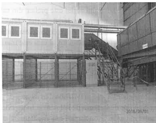
Figura nr. 4-16 Stația de sortare – echipament 2
