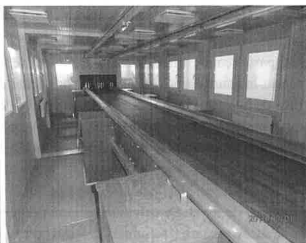
Figura nr. 4-17 Stația de sortare – echipament 3
