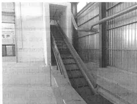
Figura nr. 4-15 Stația de sortare – echipament 1
